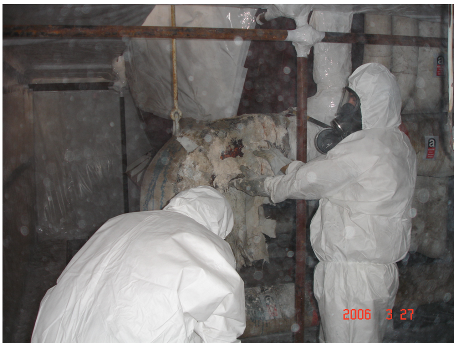
Foto n°8 – Fase di scoibentazione di tubazioni ricoperte di amianto friabile (fonte ASP – ex centrale termoelettrica del Mercure)
