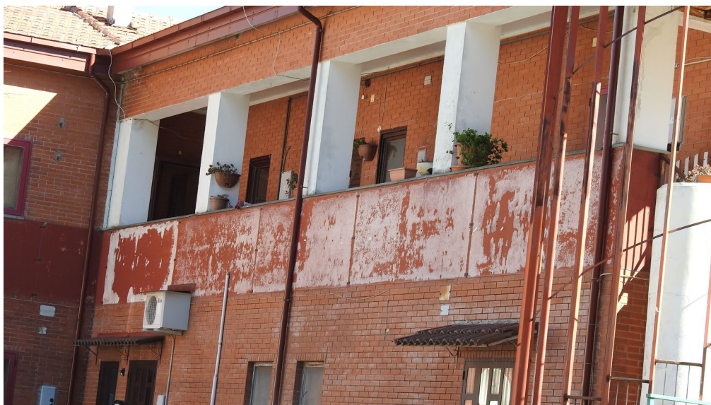
Foto n°4 – Lastre glasal utilizzate come elementi di facciata in stato di degrado (fabbricato di edilizia residenziale in Malito – Cs)
