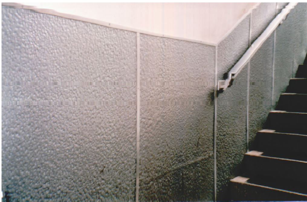
Foto n°7 – Rivestimento pareti di vano scala con pannelli contenenti amianto (fonte ASP – ex centrale termoelettrica del Mercure)
